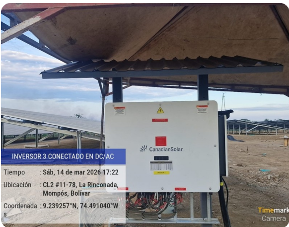
Inversores conectados en DC/AC
